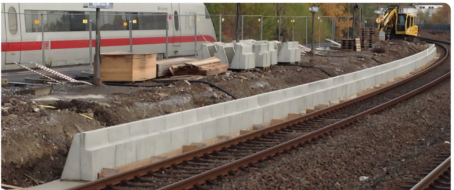
Einbauzustand der bisherigen Bahnsteigkante Typ BSK 41
