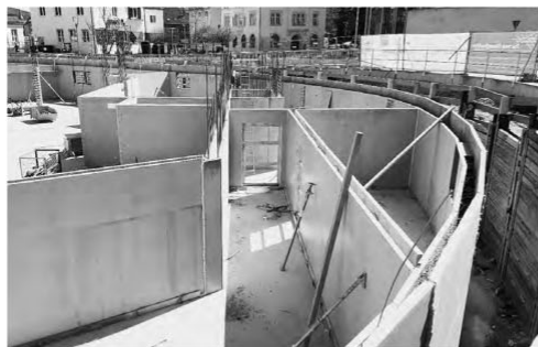
Für die Ausführung des Rohbaus wurden Betonfertigteile wie die Syspro-Doppelwand genutzt. Die Installation der Elemente lässt sich mit einem Minimum an Zeit und Baustellenelementkapazitäten durchführen.
